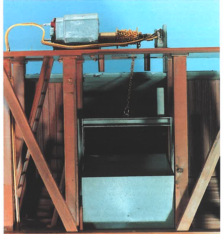
POLA: Blick auf die Antriebsmechanik des Kohlenaufzugs, mit der der Silo voll mechanisch mit Kohle beschickt werden kann.
